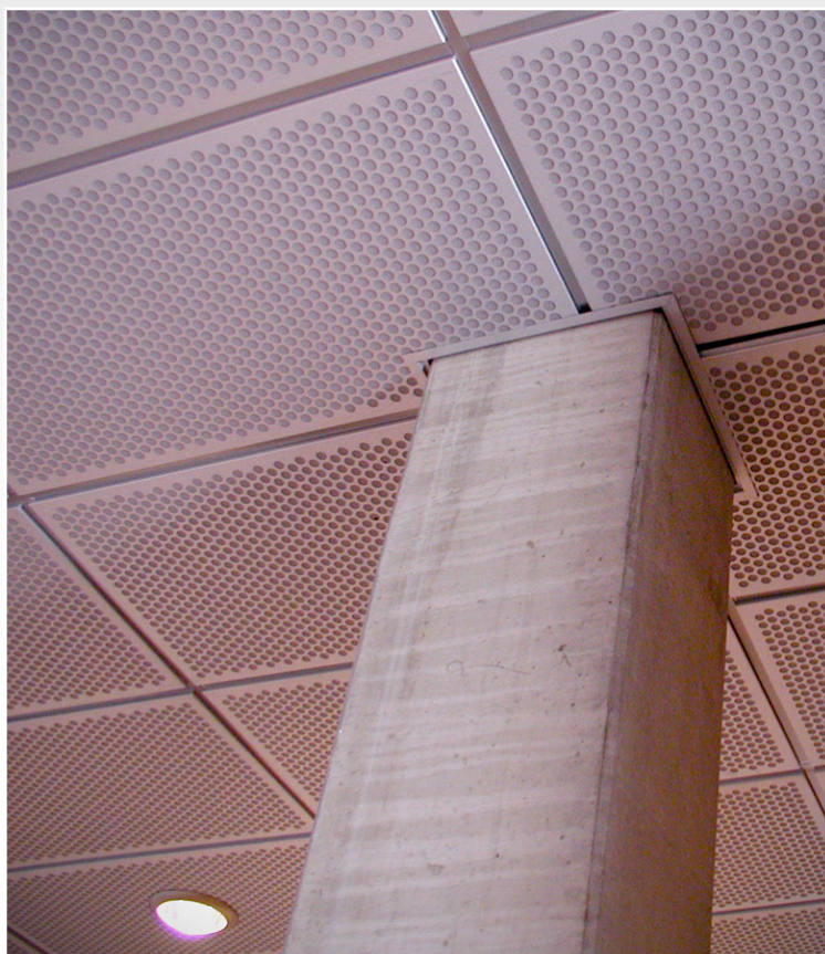
Kassett E (E24) monterat runt pelare.
