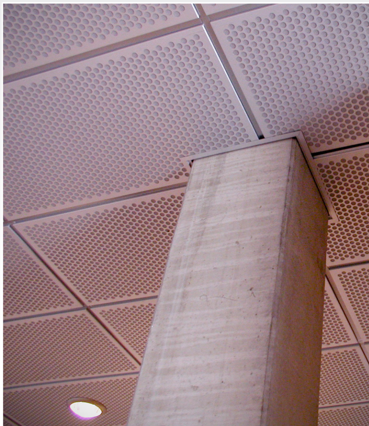
Kassett E (E24) monterat runt pelare.
